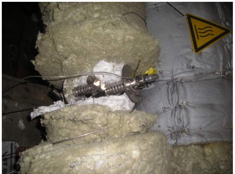
Bild 1: AS-Schneider Doppel-Absperrventil eingebaut in Versuchsanlage COMTES700 für einen Langzeit-Designtest bei 700°C (Isolierung entfernt)
